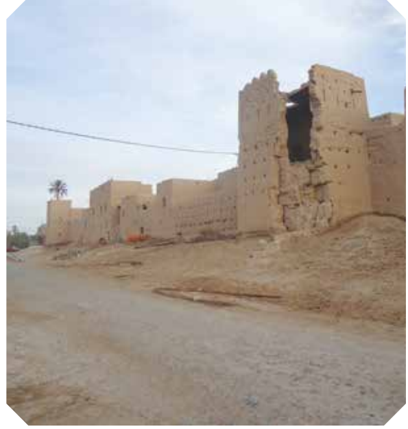
الصورة 5: تشقق وتآكل برج القصور
