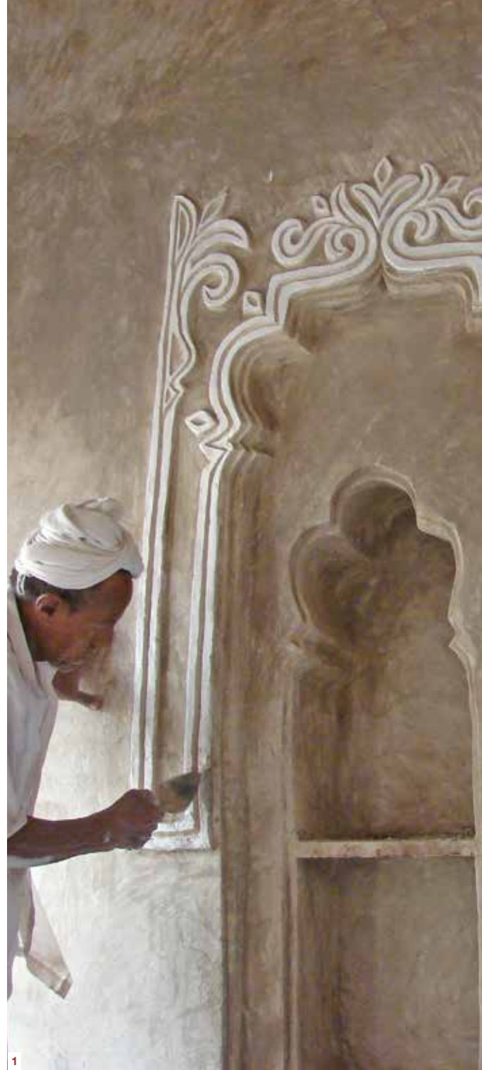
صورة رقم (2) الأسطى عمر إبراهيم العمار أثناء عملية لتشكيلات زخرفيه من نوع "صورة" بعد انتهائه من عملية البناء وتسوية الاسطح.
